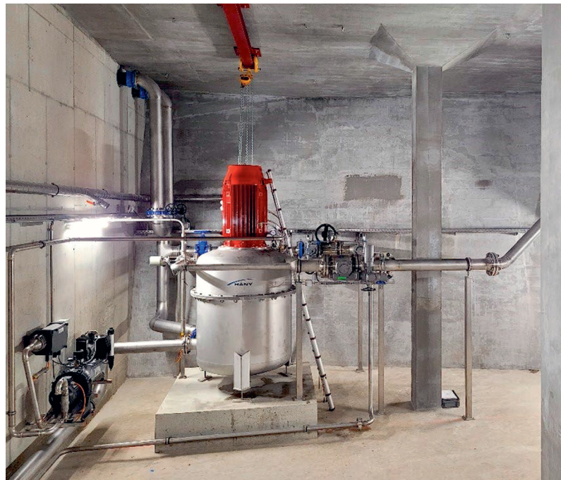
Gegendruckturbine Tréfois im Trinkwassernetz der Stadt Monthey (VS) (Nenndurchfluss 65 l/s, Nettofallhöhe 397m, elektrische Leistung 217 kW) mit 4m Wassersäule Gegendruck, Inbetriebnahme im November 2021.
