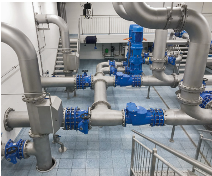
Kombination von Klappen, Rückflusssperren und Ein- und Ausbaustücken – alles geliefert von Hagenbucher.
