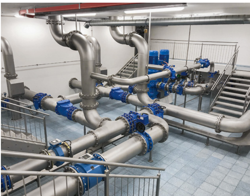
Rohrkeller im neuen Reservoir Gönhard.
