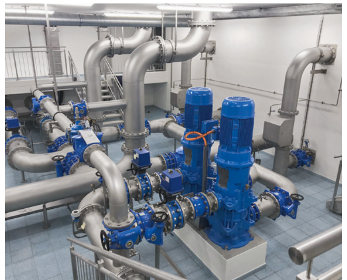
Pumpenaggregate mit den von Hagenbucher gelieferten Düsenrückschlagventilen.
