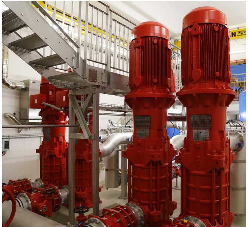
Fig. 4 Das Innenleben des neuen Grundwasserpumpwerks in Saanen. Hinter den vier mächtigen Pumpen folgen die UV-Behandlung sowie Klappen und Expansionsgefässe zur Abfederung möglicher Druckschläge.
