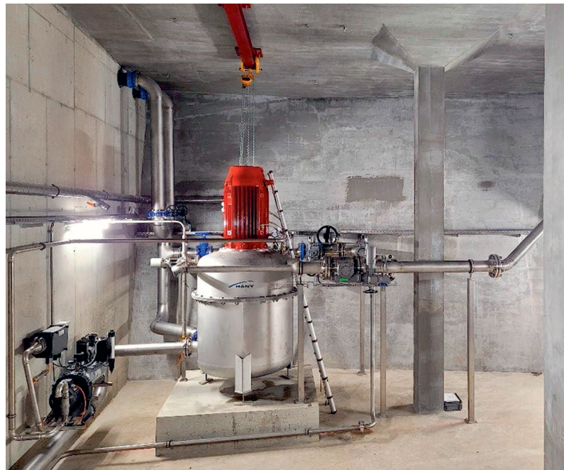
Turbine à contre-pression de Tréfois sur le réseau d'eau potable de la Ville de Monthey (débit nominal de 651/s, 397 m de chute nette nominale, puissance électrique de 217 kW) avec 4 mCE de contre-pression, mise en service en novembre 2021. Häny AG
